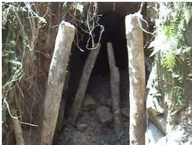
Foto No 06 bocamina abandonada por derrumbes por la falta de sostenimiento
