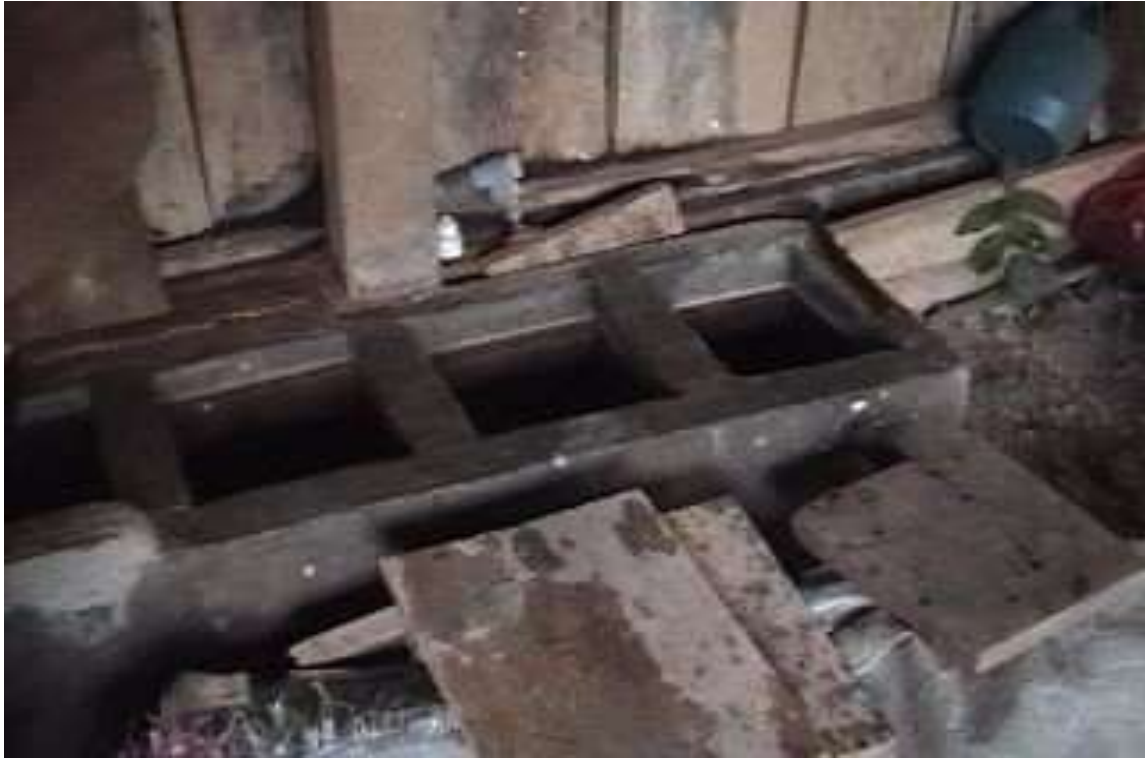
Foto No 28 Cajas de precipitación oro en un proceso de cianuración, planta los Acosta, vereda el Tamboral.
